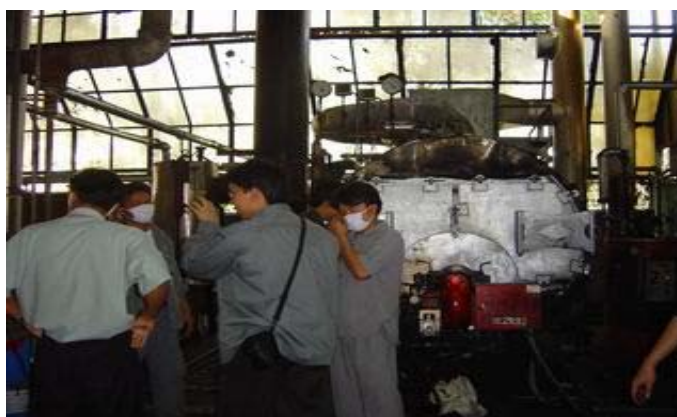
รูปที่ 6.1 หม้อไอน้ำที่ใช้ในโรงงาน
